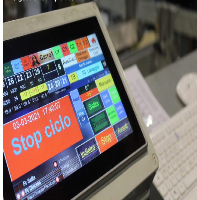
Consolle di controllo e gestione impianto
